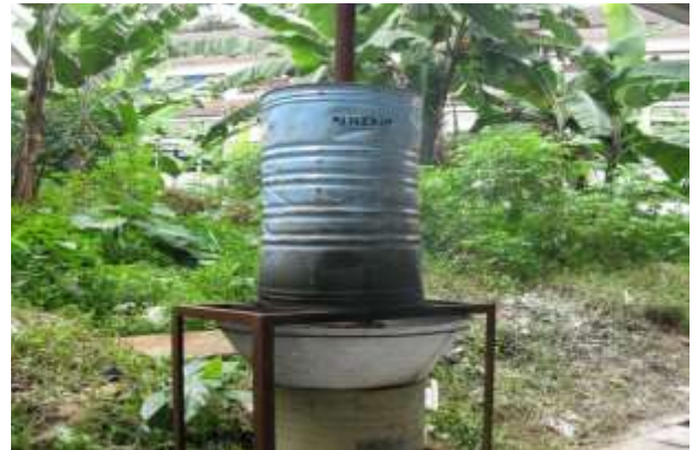
Gambar 4. Drum sebagai wadah air, dengan menggunakan boiler
